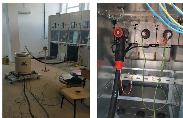
Slika 5 - Ispitivanje novog postrojenja
