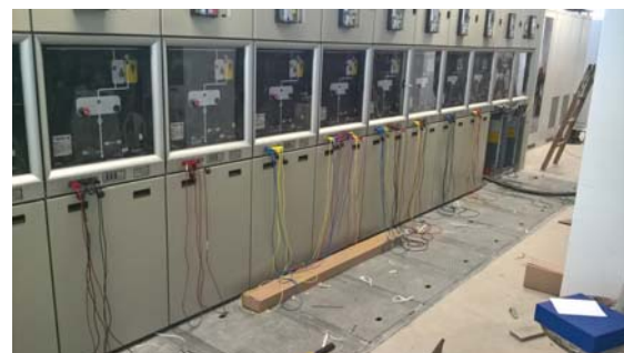
Slika 4 - Ispitivanje novog postrojenja
